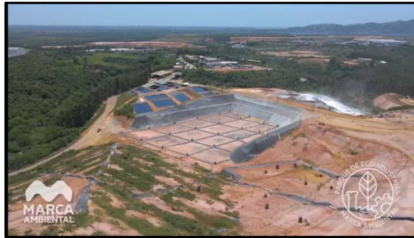
Drenagem de Biogás e Percolados
