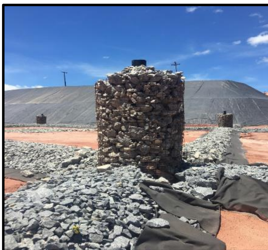
Drenagem de Biogás e Percolados
