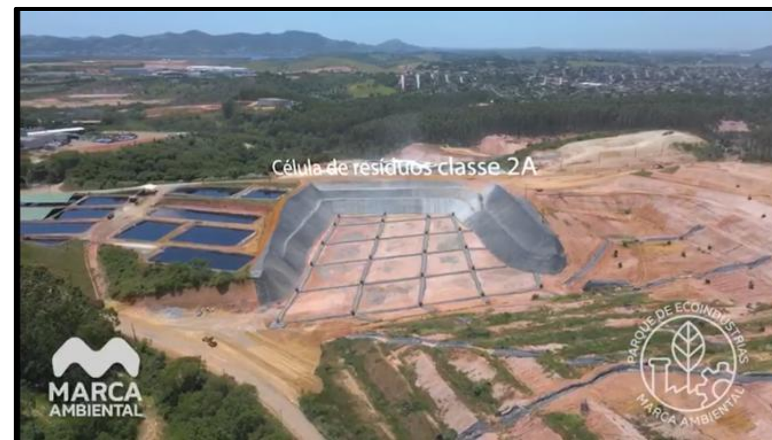
Drenagem de Biogás e Percolados
