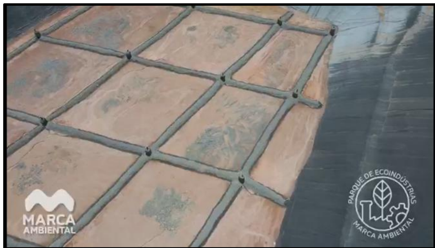
Drenagem de Biogás e Percolados
