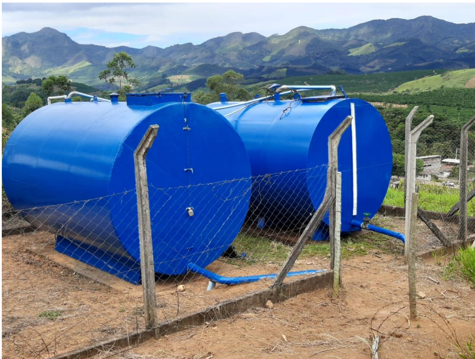
Reservatórios de Distribuição existentes (Padrão Pró-Rural)
