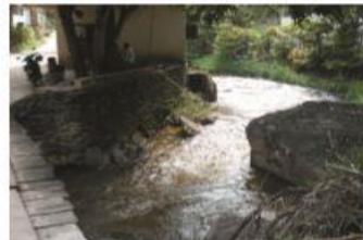
Estreitamento do rio, provocado por construção inadequada
